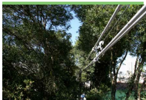
Figura 41 – Detalhe da fiação compacta
