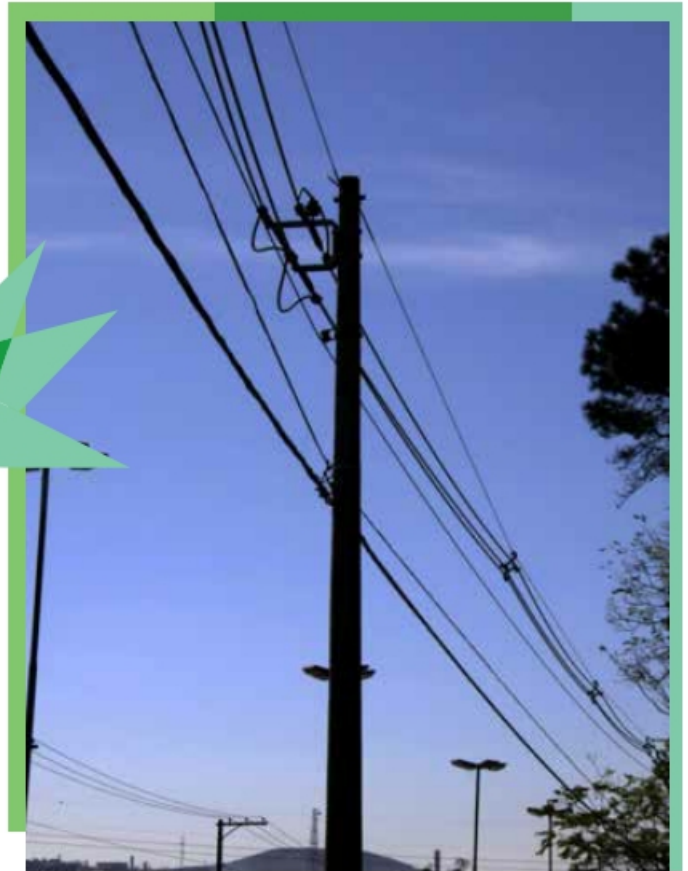
Figura 19 – Disposição do cabo em poste
