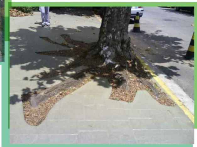
Figura 46 – Piso de calçada refeito contornando raízes
