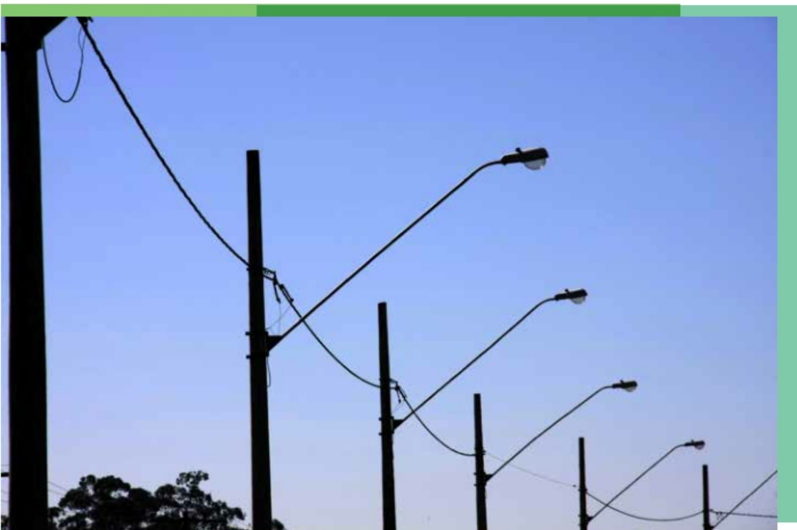
Figura 20 – Disposição do cabo em poste
